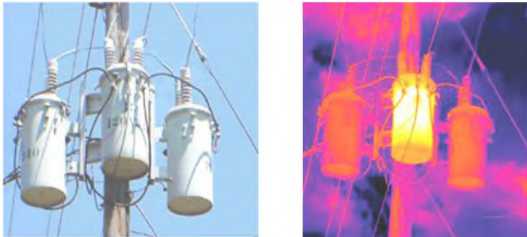
Рисунок 4 Фото и термограмма: распределительный трансформатор (слева), термограмма распределительного трансформатора (справа)
